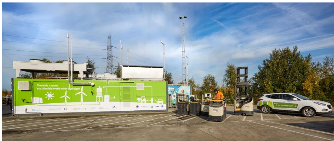
Figuur 4.3 : 0,6 MW alkalische elektrolyse en 0,3 MW PEM-elektrolyser-installatie bij Colruyt (Halle, B) voor het leveren van waterstof aan heftrucks en auto's
